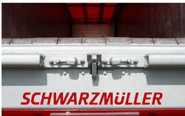
Hecktüre unten: Verschlusszapfen auf Beschädigungen und Schrauben auf Festsitz prüfen
