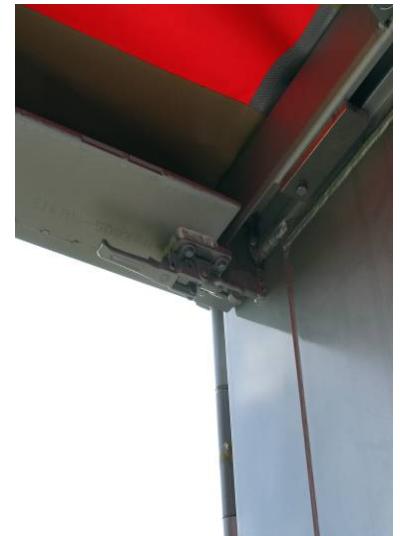
Verriegelung am Heckportalbalken: Schrauben auf Festsitz prüfen, Schweißnähte auf Risse prüfen
