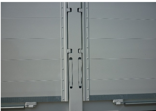
Mittelsäule und Ecksäulen (vorne und hinten): Funktion der Verriegelung prüfen
