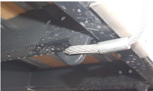
Gegenhaken für Seilspannrollen: Schweißnähte auf Risse prüfen
