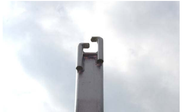
Rungenlager innen: Schweißnähte auf Risse prüfen
