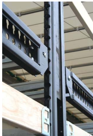
Mittelsäulen seitl.: Nieten der Schiene auf Festsitz prüfen
