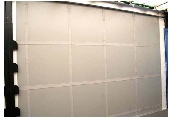
Planeninnenseite: Schweißnähte der Gurtverstärkungen auf Risse prüfen
