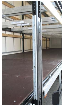
Mittelsäulen seitl. Unten: Nieten auf Festsitz prüf.
