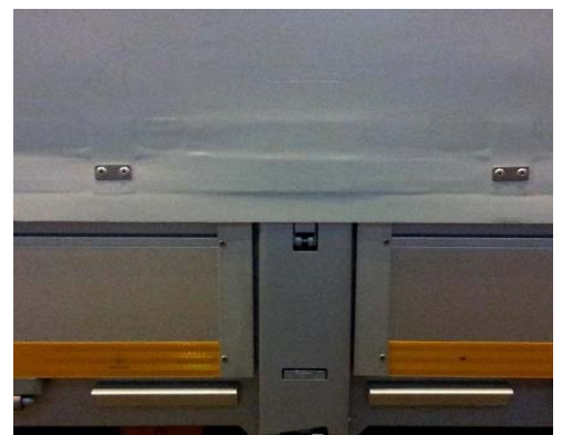
Quick-Slide-Spanner: Nieten auf Festsitz, Gurte und Spannelemente auf Beschädigung und Risse prüfen
