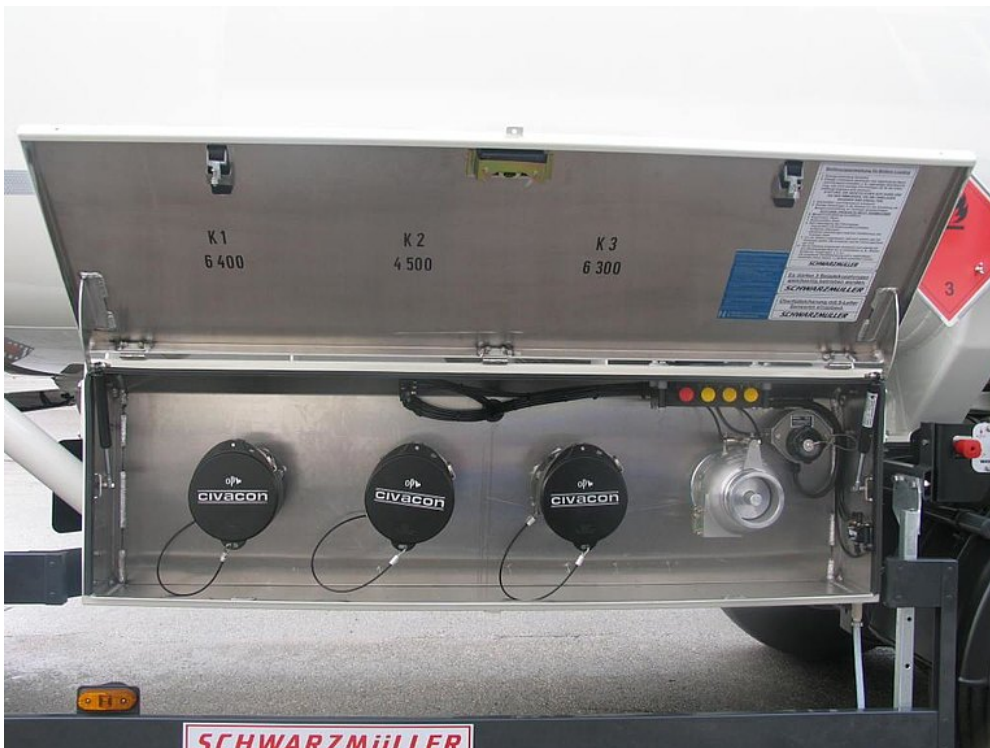
Přehledné uspořádání armatur pro efektivní a bezchybné ovládání
