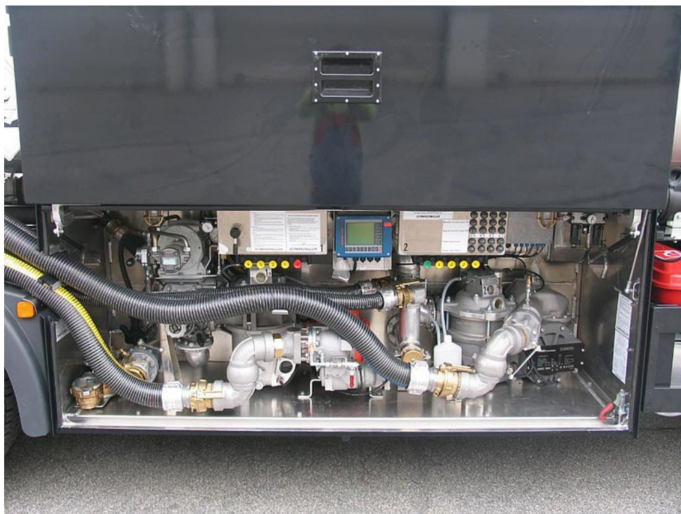
Přístrojová skříň s jednodílným paralelně otevíraným víkem
